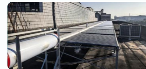
浴室太阳能集热装置
